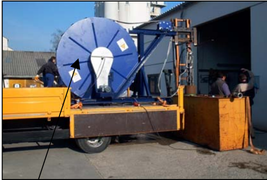
Testschnitt im Werk Haspel für Versorgungsleitungen des Manipulators (Motor, Tragseil, WAS Schlauch)
