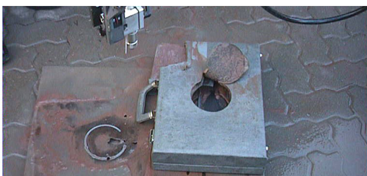
Inspektionsöffnung in einem Koffer
